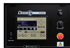
탑재 발전기 판넬 (기계식 | 전자식)
