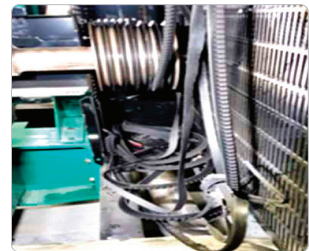
사례 2 : 팬벨트 점검 미흡으로 벨트 풀림으로 인한 파손, 탈락
