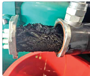
사례 1 : 냉각수방치로 인한 히터 및 라디에이터 손상교체
